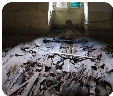
⑬ Plancher détruit
