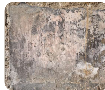
⑩ Charpente bois
