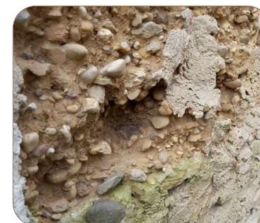
⑮ Pisé, reprises ciment
