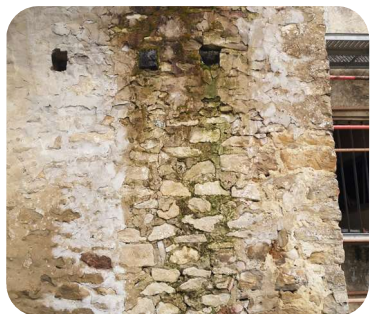
⑦ Coulée d'humidité sur la maçonnerie pierre
