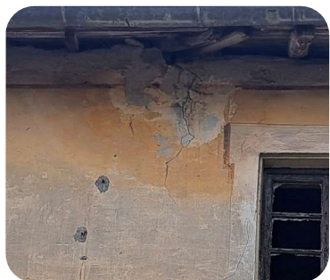
② Ravine et fissure dans la maçonnerie pierre
