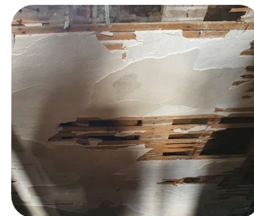
⑮ Poutres et sol effondré, bois et plâtre
