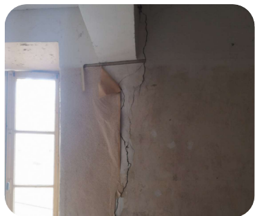
⑥ Fissures sous les poutres
