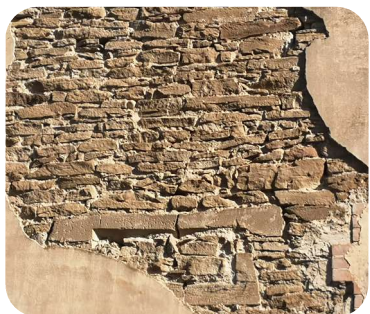
① Enduit décollé sur la façade
