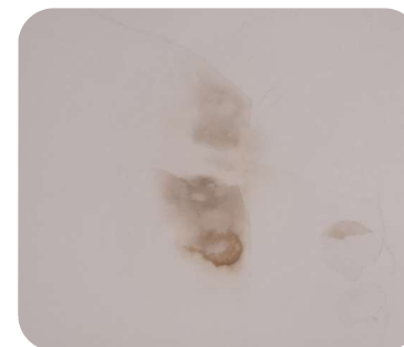
⑮ Trace d'humidité plafond
