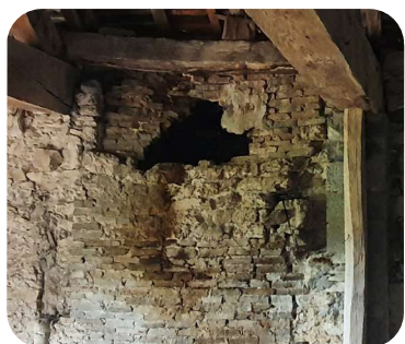
⑦ Effondrement du conduit brique
