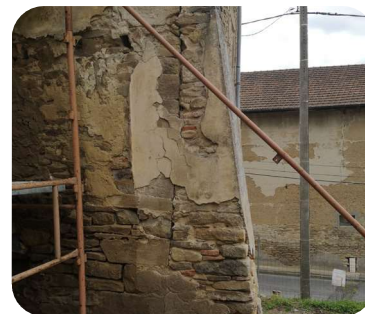
⑨ Détachement du contrefort
