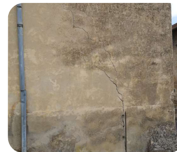
⑩ Fissure dans la maçonnerie pierre
