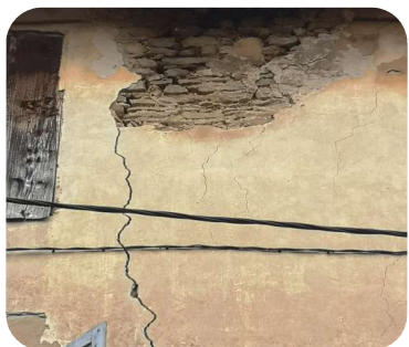
① Ravine et fissure dans la maçonnerie pierre
