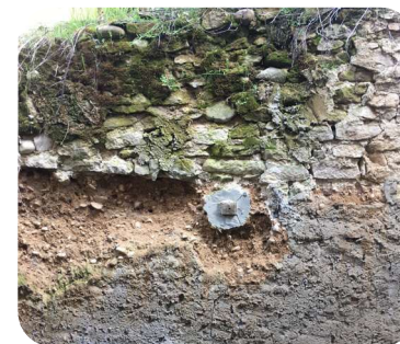
⑤ Erosion du pisé, reprise de mur en pierre et ciment
