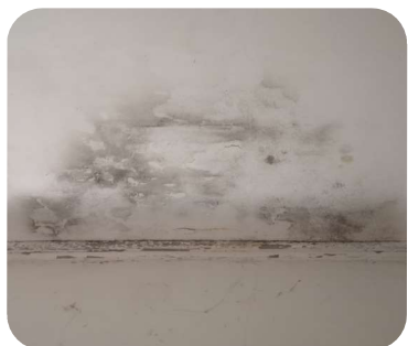
⑫ Traces d'humidité au plafond
