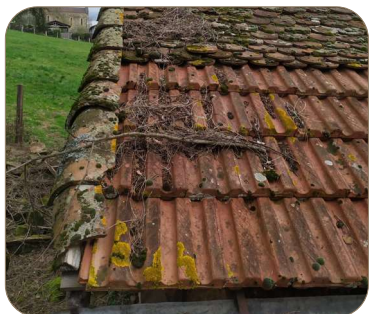
⑥ Reprises ciment sur pisé et soubassement
