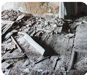
⑧ Plancher déterioré
