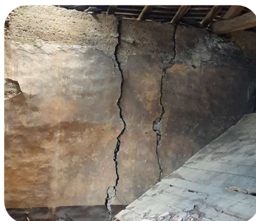
⑬ Double fissures traversantes
