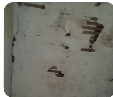
④ Plâtre plafond décollé
