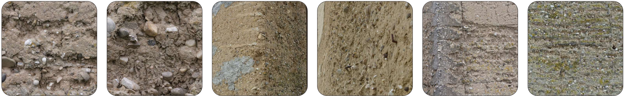
Érosion directe par la pluie
