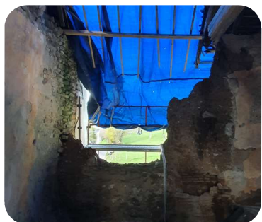
⑫ Effondrement de la cheminée et du pisé
