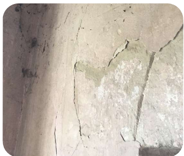
① Enduit décollé
