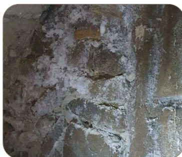
⑬ Maçonnerie pierre, salpêtre
