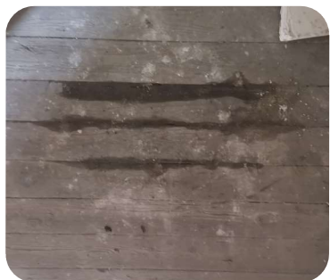
② Traces d'humidité sur le sol
