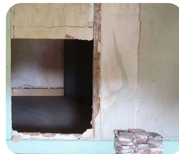
⑨ Mur en briques écroulé partiellement
