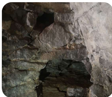
⑬ Trous dans la maçonnerie pierre
