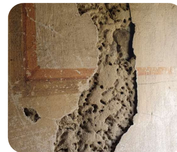
⑤ Enduit endommagé, insectes ?
