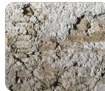
⑩ Maçonnerie pierre, traces de ciment
