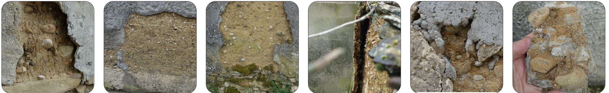
Enduits étanches - Décollement
