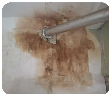
⑬ Traces de chauffage, humidité
