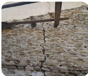
③ Fissure traversante le pisé
