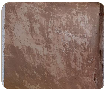
③ Plâtre, peinture, graffiti sous l'escalier
