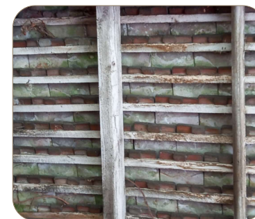
⑩ Charpente bois
