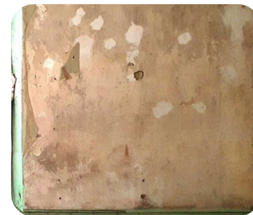
⑩ Enduit décollé
