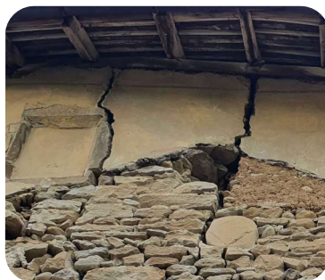
③ Fissures traversantes, flambement du mur
