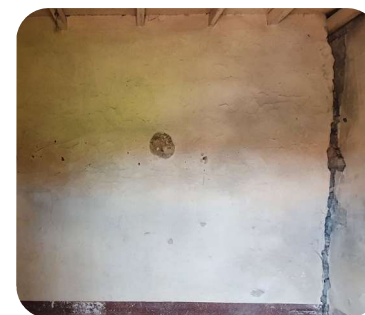
⑩ Fissure traversante rebouchée au ciment
