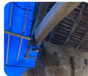
⑮ Effondrement de l'appui de la charpente
