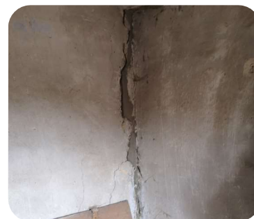
⑭ Fissure traversante, rebouchage en ciment
