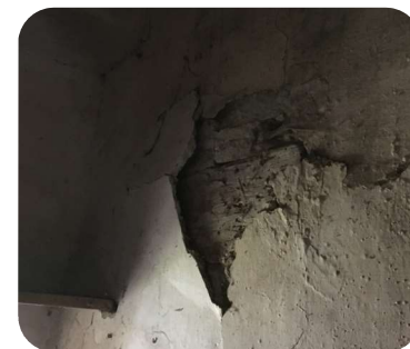
⑤ Décollement de l'enduit
