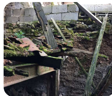
④ Toiture effondrée, débris et végétation
