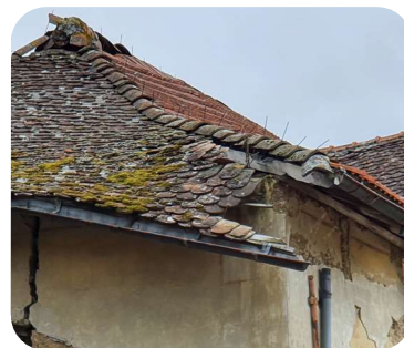
④ Toiture endommagée
